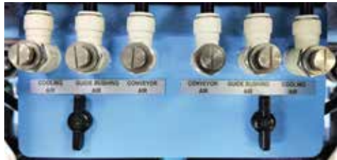
Centralized compress air controls 集中化されたエアコントロール
